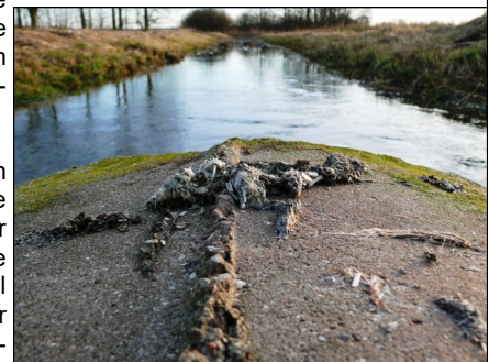
Abb.4: Otterlosung auf einem Rohrdurchlass
