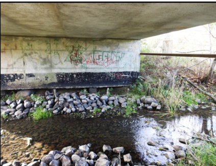
Abb.1: Zustand der Brücke am 22.10.2019, insbesondere der niedrige Wasserstand verdeutlicht das Problem an den Wiederlagern
